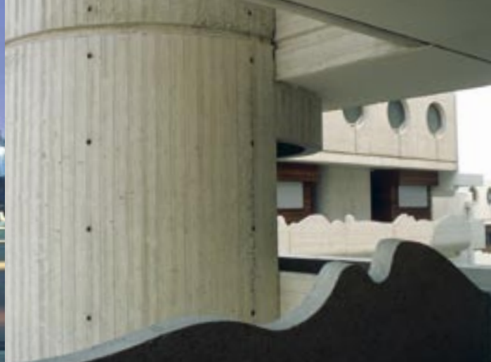
Les habitants des « Vagues » accèdent par des coursives à leur appartement. Les garde-corps ondulés en béton brut fonctionnent comme un jeu, à la hauteur du regard des enfants.
